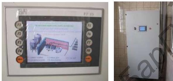
Рис. 2. Общий вид шкафа управления и панели контроллера РР45
