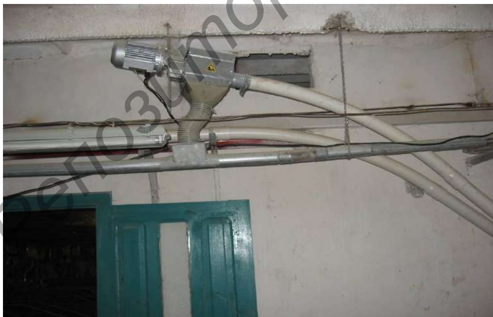
Рисунок 3 – Вид на привод кормовых труб и кормовые трубы линии поперечной раздачи
