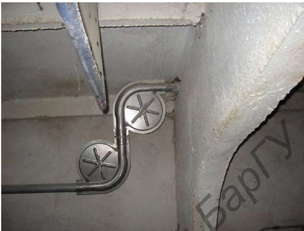
Рисунок 4 – Вид на поворотные устройства линии раздачи корма
